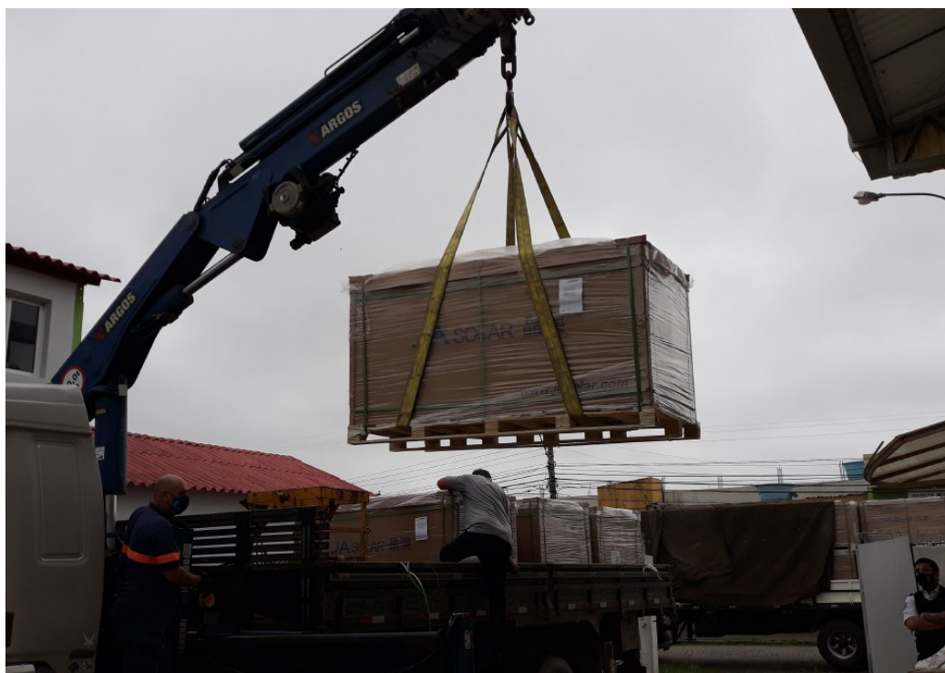
Figura 9 - Recebimento de usina fotovoltaica
