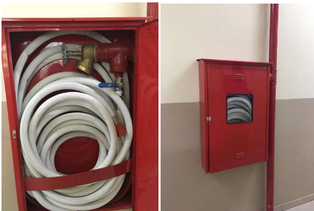
Figura 6: Rede de Hidrante do tipo Mangotinho com conector STORZ
