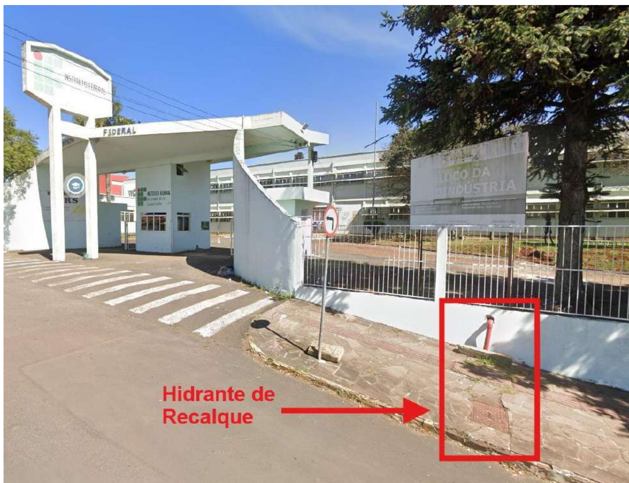
Figura 2: Localização do Hidrante de Recalque.
