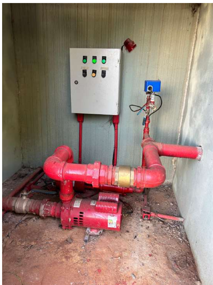
Figura 3: Casa de Bombas do Bloco 2.
