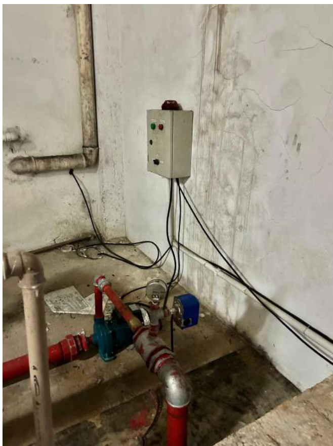
Figura 5: Casa de Bombas do Bloco 3.
