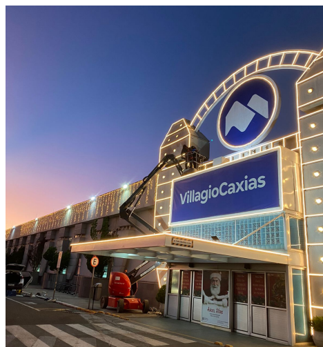
Figura 7. Resultado do projeto técnico de iluminação para fachada de natal Shopping Villagio Caxias - onde foram instalados cerca de 3.000 metros de LED entre as fachadas do shopping.
